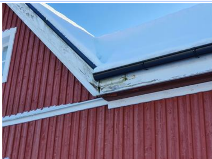
Tak: Skador noterades i takfot.
