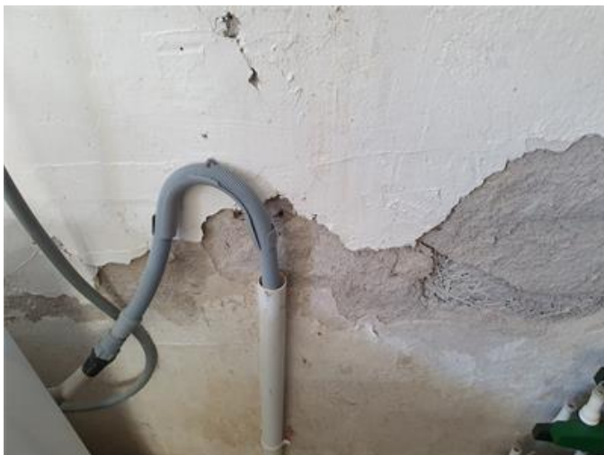
Tvättstuga: Putssläpp förekommer på väggar
